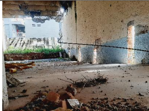
Área interna con deterioros, escombros y vegetación menor
