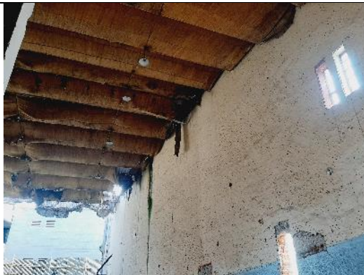
Área interna con deterioros,
