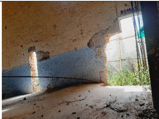
Área interna con deterioros y vegetación menor
