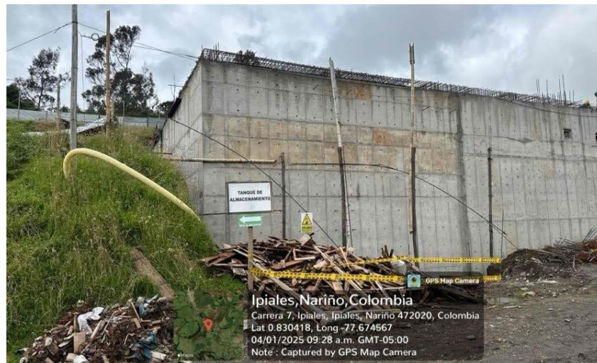
Fotografía 8. Vista lateral tanque de almacenamiento
